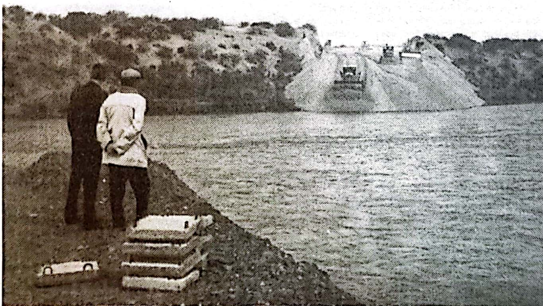
Iniciación de las obras de desvío del río. Las máquinas trabajando en la margen rionegrina (1964).
